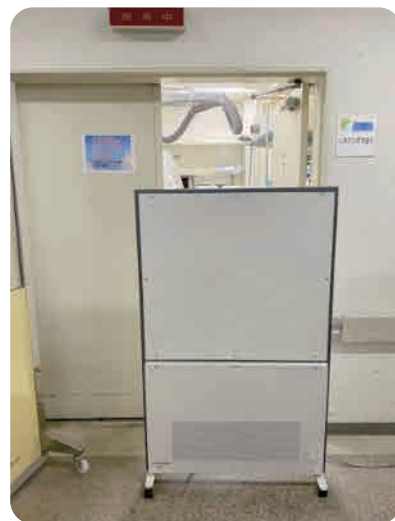
▲クリーンパーテーション
